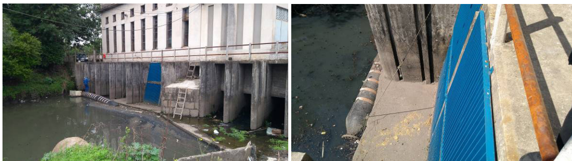
Figura 3. Fotografias das grades de contenção de resíduos sólidos da Casa de Bombas do Anglo.
